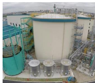
横根バイオガス発電施設
