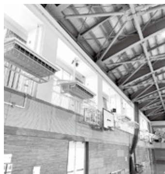
▲学校体育館の空気調和設備
