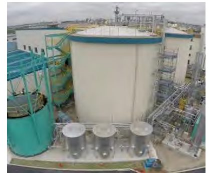
横根バイオガス発電施設
