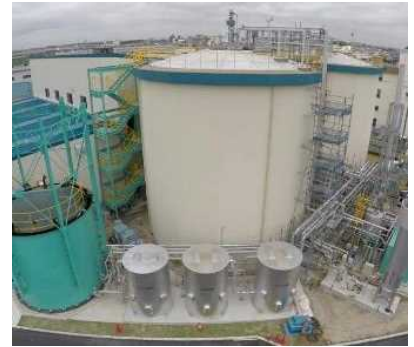
横根バイオガス発電施設
