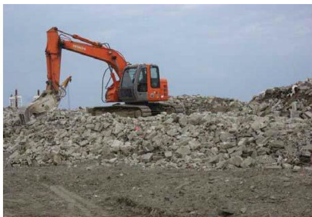
【写真1 コンクリートがら】
